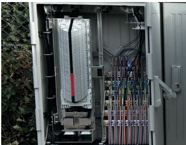
Glasfasernetzverteiler, Stromanschlusssäule und Multifunktionsgehäuse bilden zusammen ein sogenanntes Straßen-Kabinett
