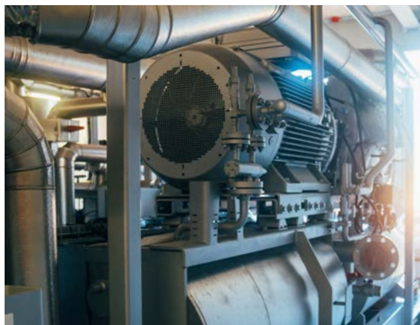
Die Wärmepumpe ist eines der drei iKWK-Systeme
