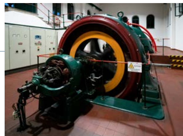
Eine der Turbinen am Wasserkraftwerk Oberwöhr
