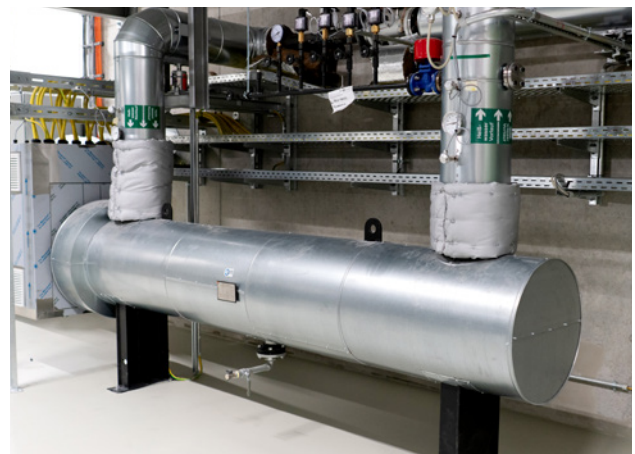
Blick auf den Elektrokessel im iKWK-Werk Oberaustraße
