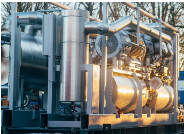
Die Wärmepumpe in der Schönfeldstraße.
