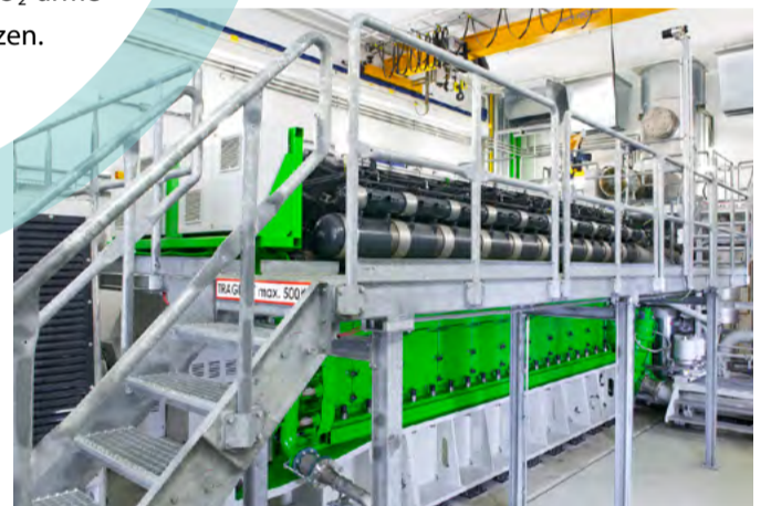
Mehrere Gasmotoren betreiben die Stadtwerke mit Biomethan.
