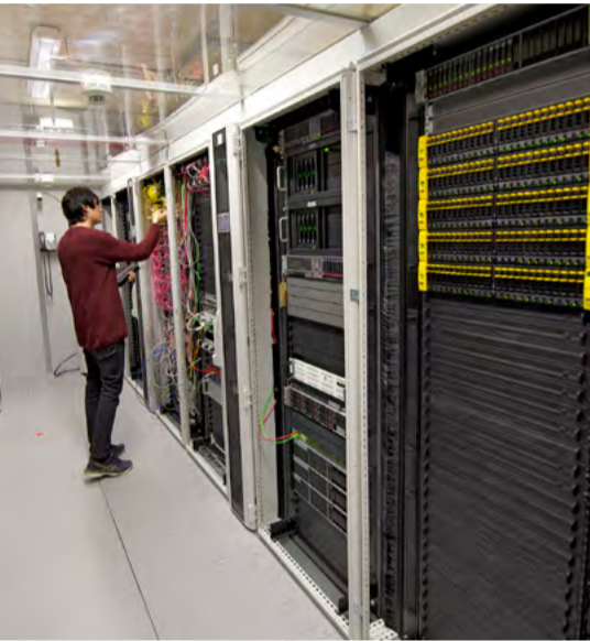
Serverräume und Rechenzentren werden mit der verlässlichen Kältelösung wirksam gekühlt.
