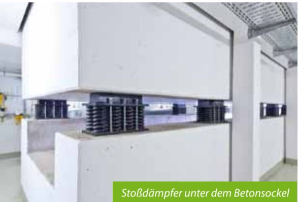
Strom und Wärme für Rosenheim
