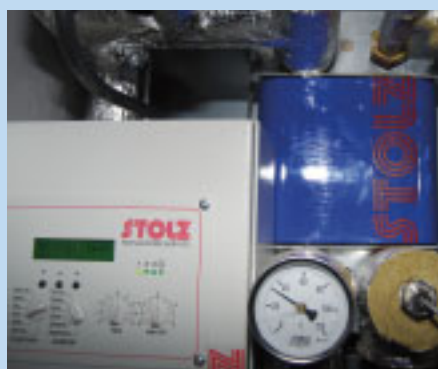
Stadtwerke-Abteilungsleiter Horst Neugebauer kontrolliert die Kompaktstation für Heizung und Warmwasser (Bild oben) sowie den Wärmetauscher für das Frischwassermodul (Bilder unten).
