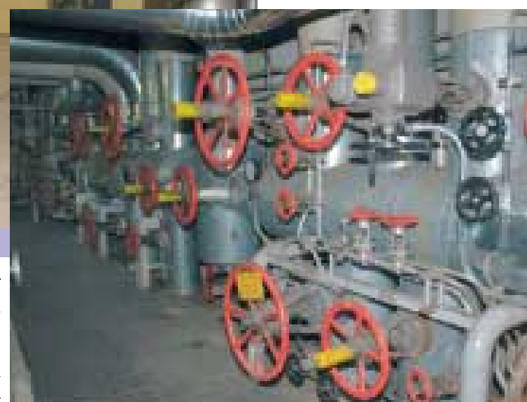
Immer unter Dampf: 60-bar-Dampfverteiler
